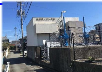
桜橋第1ポンプ場(機械設備)
