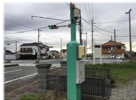
マンホールポンプ場(電気設備)
